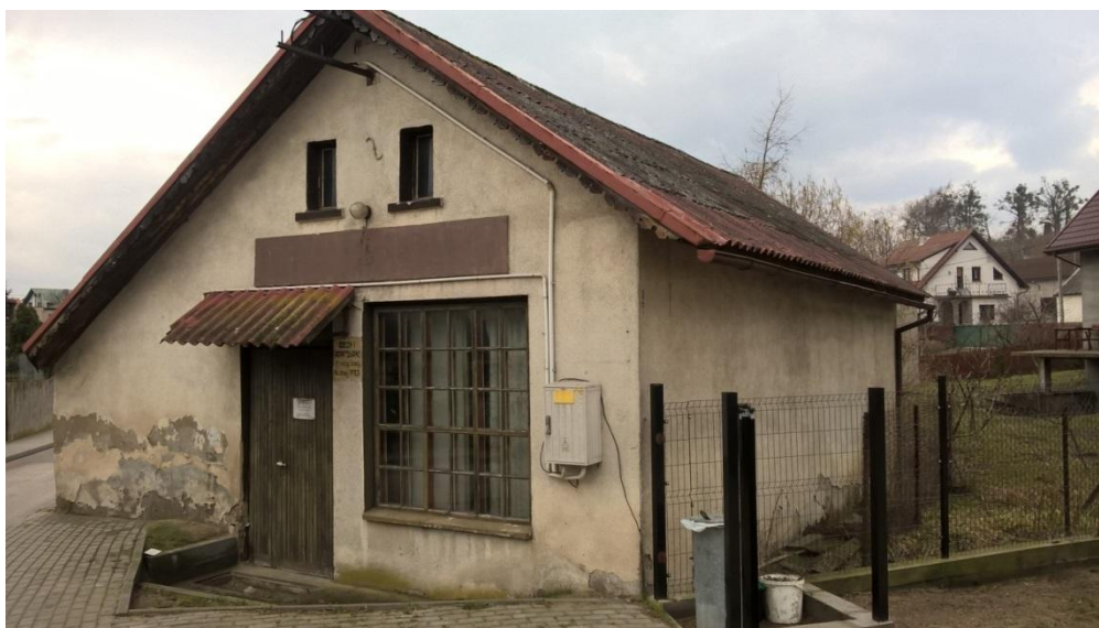
Zdjęcie 8. Zdegradowany budynek planowany do adaptacji na cele Centrum Działań Kreatywnych w Górznie
