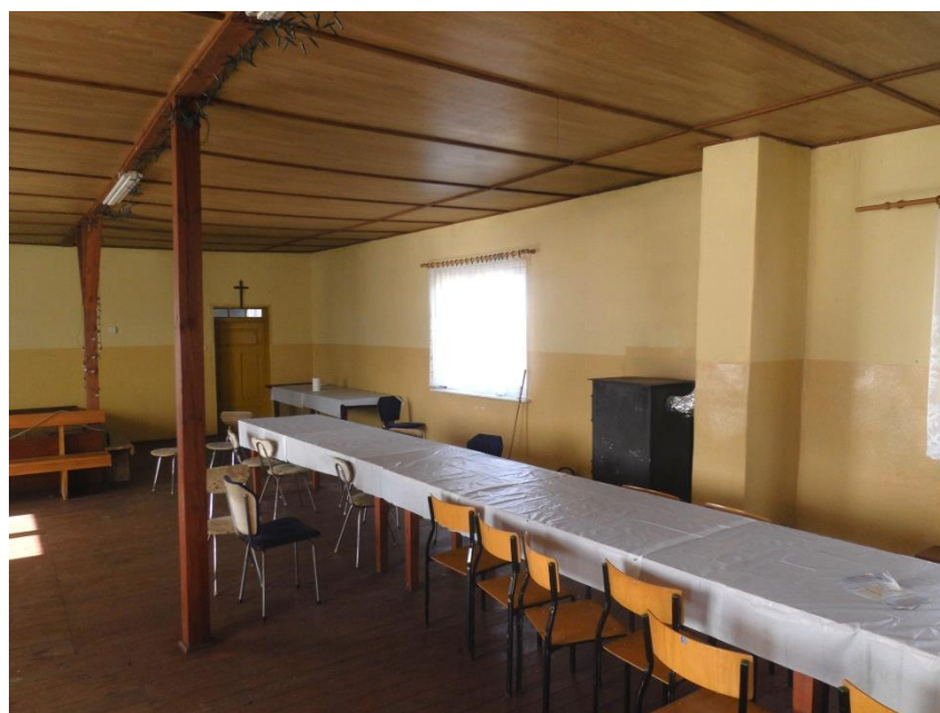
Zdjęcie 3. Stan świetlicy wiejskiej w Szynkówku
