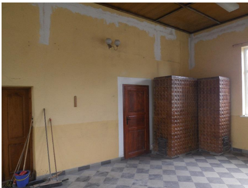
Zdjęcie 1. Stan świetlicy wiejskiej w Miesiączkowie
