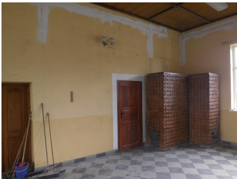
Zdjęcie 1. Stan świetlicy wiejskiej w Miesiączkowie
